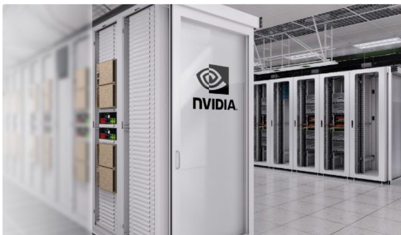
KI-Rechenzentrum. Bild: NVIDIA (Unternehmenswebsite)
