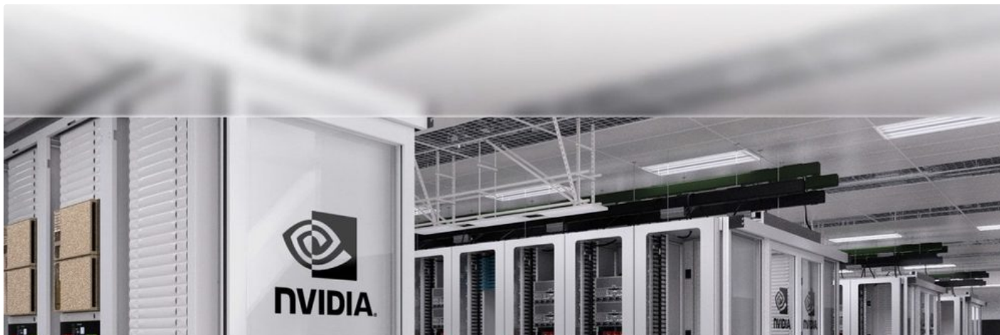
KI-Rechenzentrum. Bild: NVIDIA (Unternehmenswebsite)
